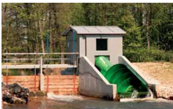
Mała elektrownia wodna
