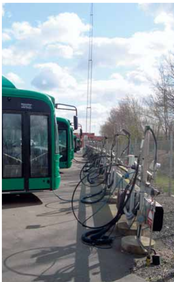
Wizyta studyjna w Szwecji, 2 kwietnia 2012. Zdjęcie przedstawia ekologiczną zajezdnię autobusową w Linköping
