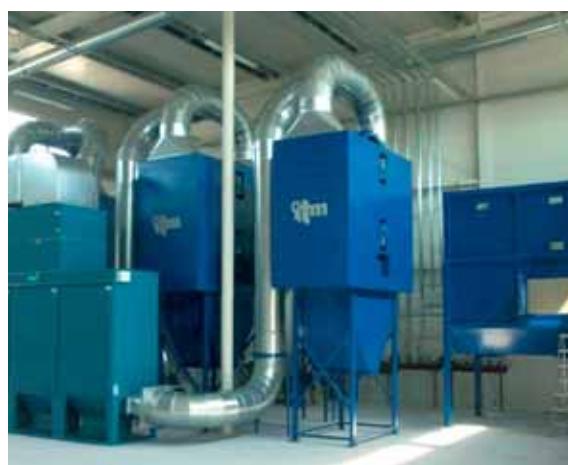
System niskotemperaturowych suszarni do biomasy – hala PWC
